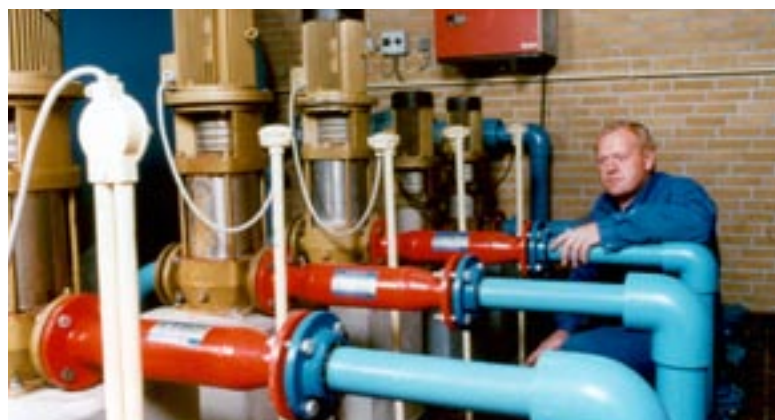
For bare 80 kroner pr. husstand, har tre magnetiske vandbehandlere på Gedesby Vandværk, gjort underværker siden monteringen i 1989.
