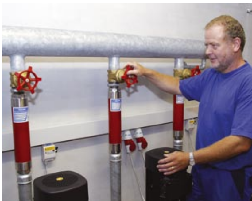
Driftsleder Ole Nielsen ved de nye vandbehandlere der blev monteret i 2003. Foto: Lolland-Falsters Stiftstidende.
